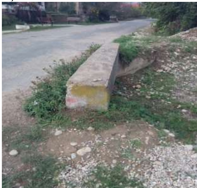
Podețe transversale colmatate pe DJ 673 E
