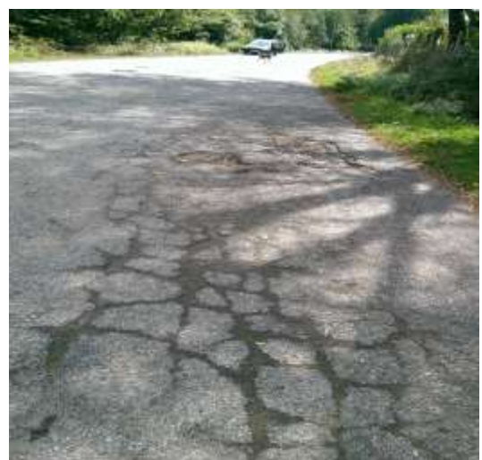
Degradări pe DJ 671
